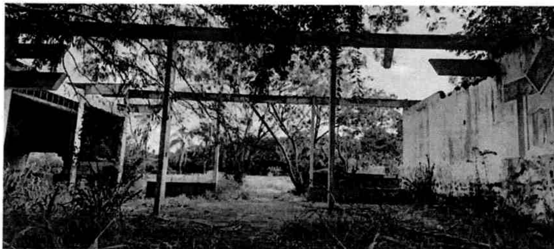
Foto 04: toda a cobertura, portas e janelas foram arrancadas.
